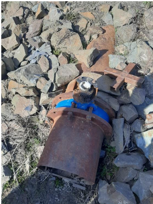
Фото до ремонта
