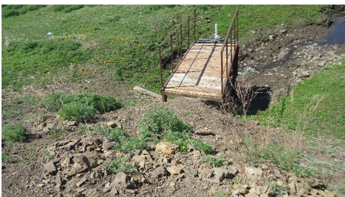
Фото до ремонта
